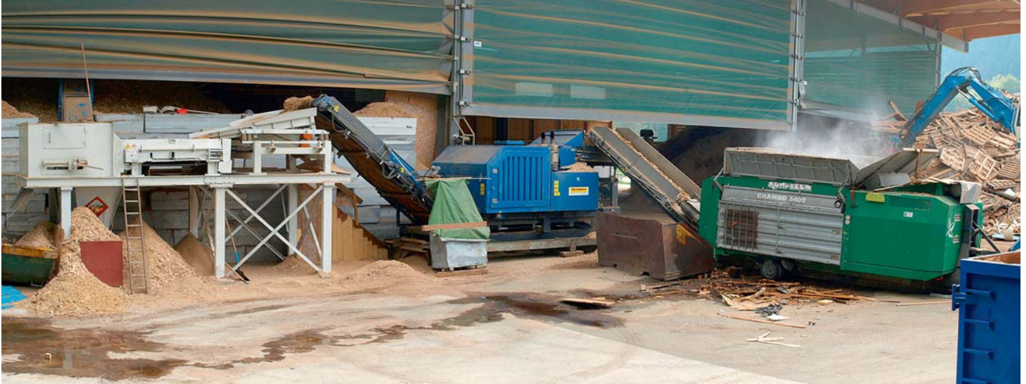
Altholzaufbereitungsanlage: Vorzerkleinerung / FE-Abscheidung / Feinzerkleinerung / NE-Abscheidung
