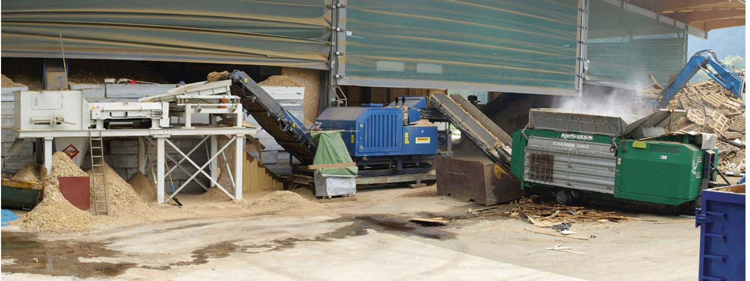
Installation de préparation du bois usagé : broyage préalable / séparation FE / broyage fin / séparation NE
