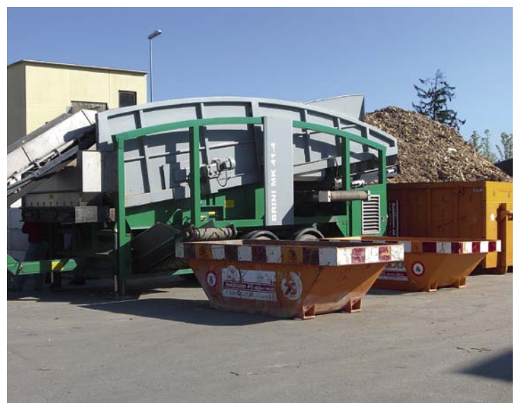
Installation de tri pour matière valorisable « Brini »
