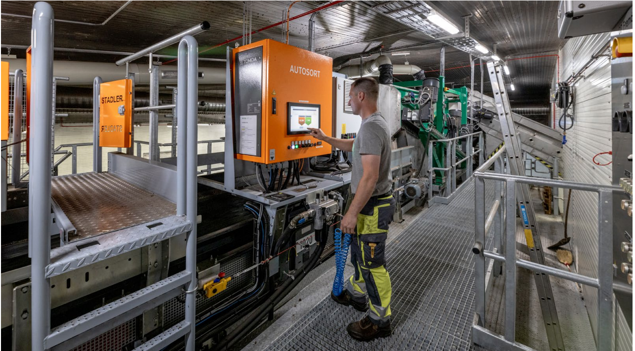
Zentrale Steuerungseinheit der neuen Bioabfallverwertungsanlage bei SFPI in Inwil
