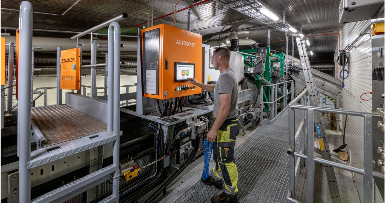
Unité centrale de commande de la nouvelle installation de valorisation des biodéchets chez SFPI à Inwil.
